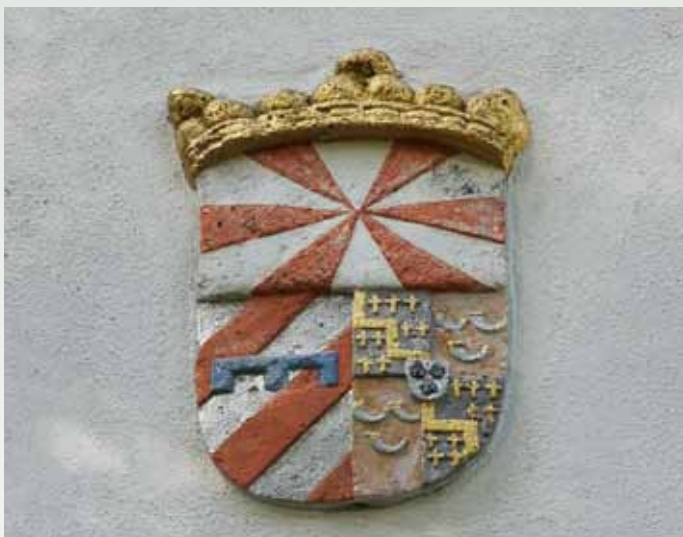
Die Wapen an der von der Sonne besonders intensiv ausgesetzten Fassadenseite verblässen immer mehr. In der Folge wird auch der Stein in Mitleidenschaft gezogen.
