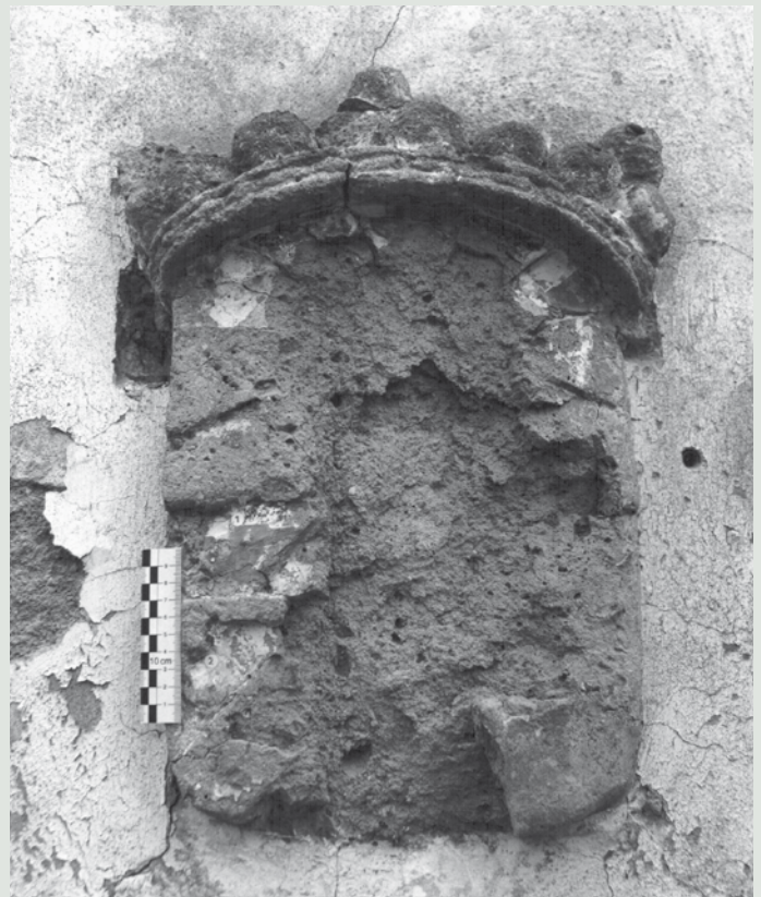
So weit soll es nicht mehr kommen: Das Bild oben entstand 1993 bei der Zustandsanalyse der Kapelle und zeigt eines der Wapen zu dem Zeitpunkt, als die Kapelle von der Gemeinde gekauft wurde. Da wurde viele Jahrzehnte vorher nichts gemacht und dem Verfall preisgegeben.
